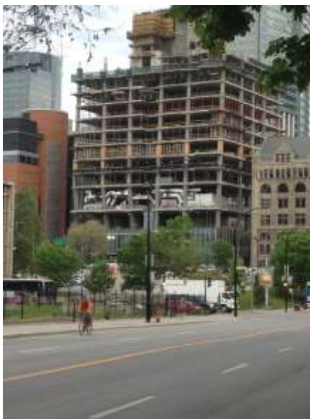
Une vue spectaculaire du 4 e étage du complexe où l'on retrouve la salle mécanique
